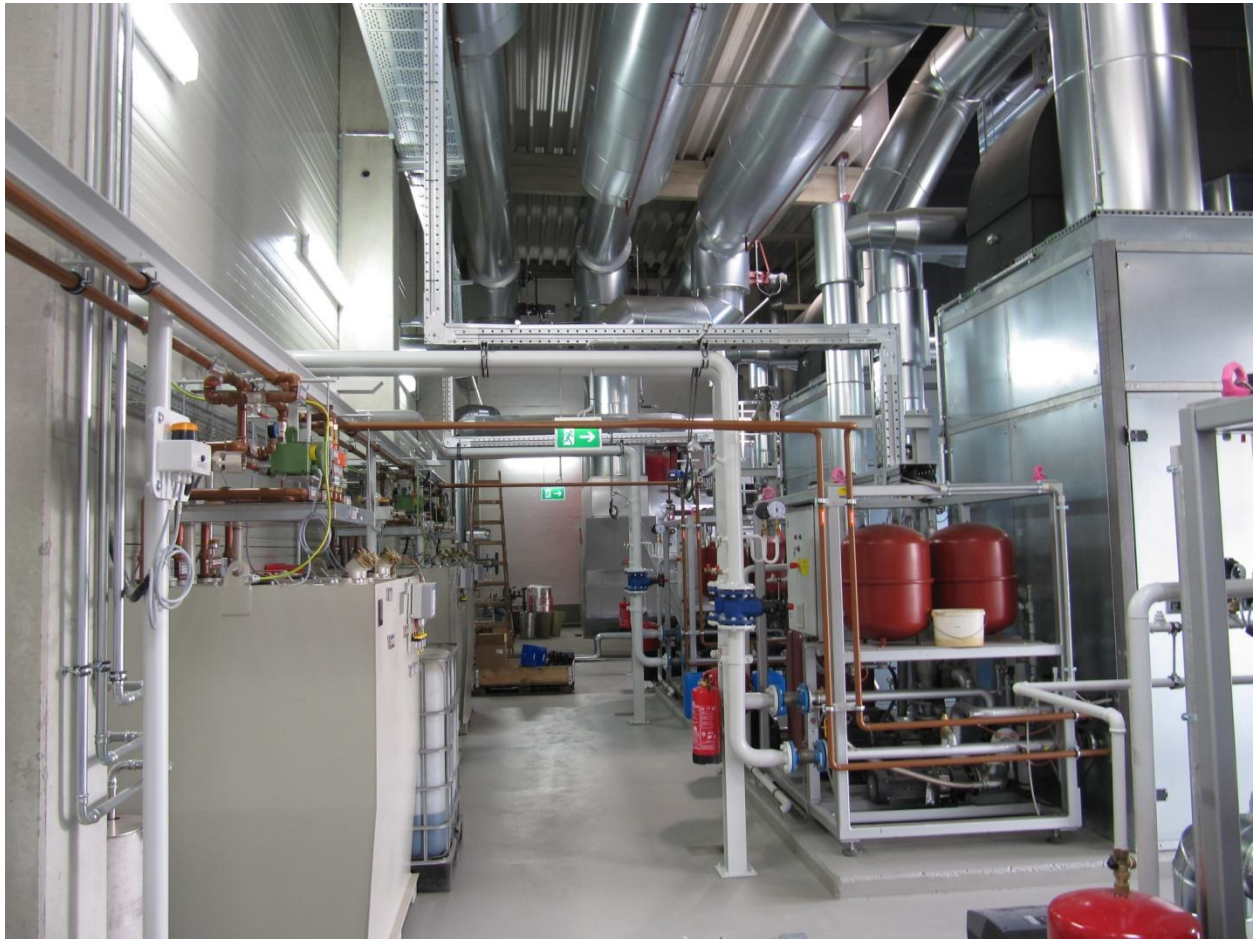
Energiecentrale met rechts de omkastingen van de gasmotoren.
